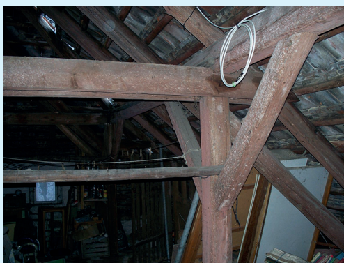
Původní konstrukce krovu brání vestavbě
